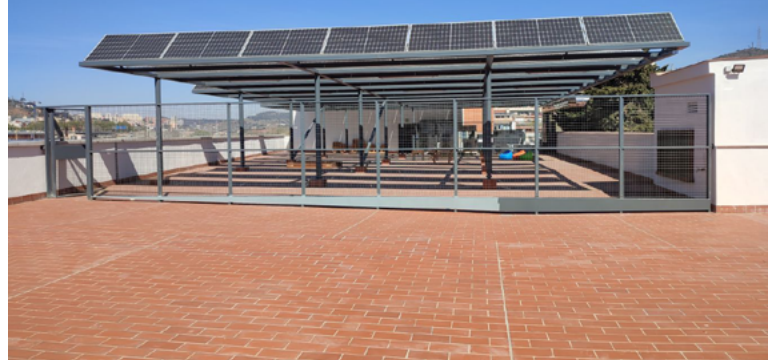
› Terrassa amb plaques solars.
