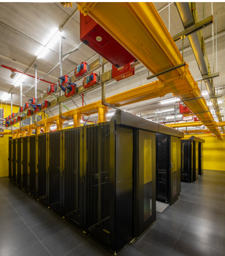
A T > La sala CPD, centre neuràlgic de l'edifici del SEM, garanteix la continuïtat operativa.
