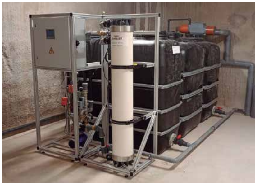
Sala tècnica amb equip d'aigües grises amb tractament bio-mecànic, per membranes d'ultrafiltració tipus multibore (GEP Ibérica)
