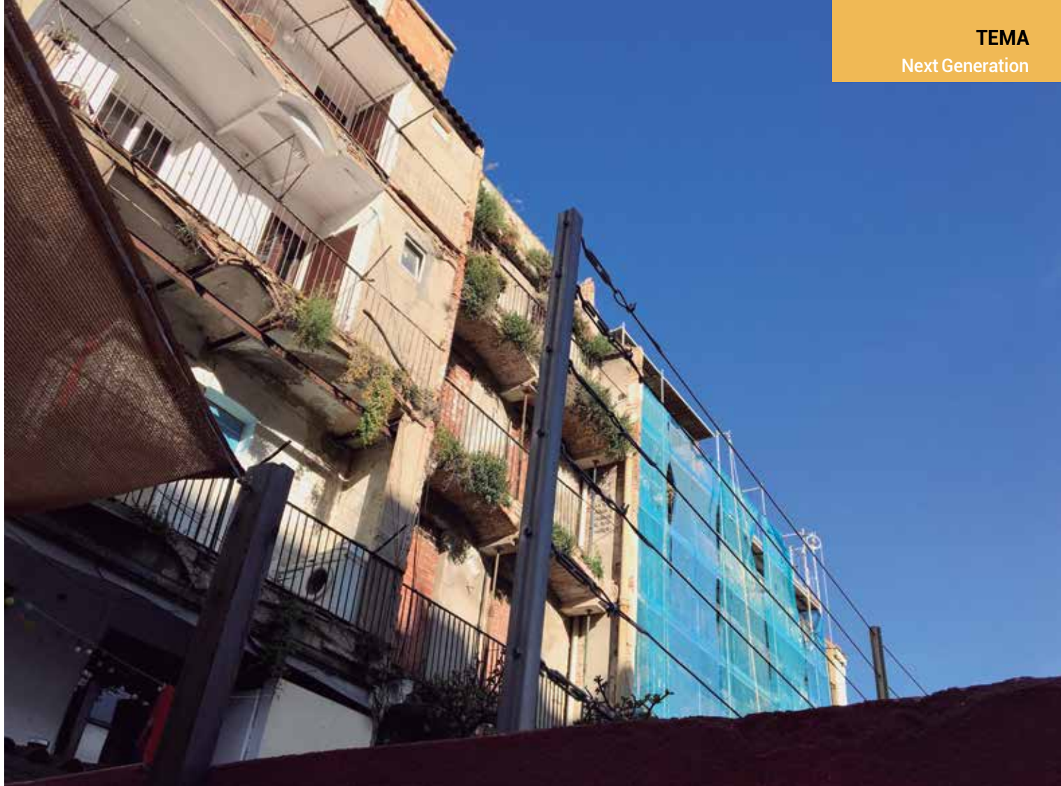
Molts edificis presenten un estat de conservació lamentable i requereixen una intervenció urgent (Foto: Aina Gatnau)
