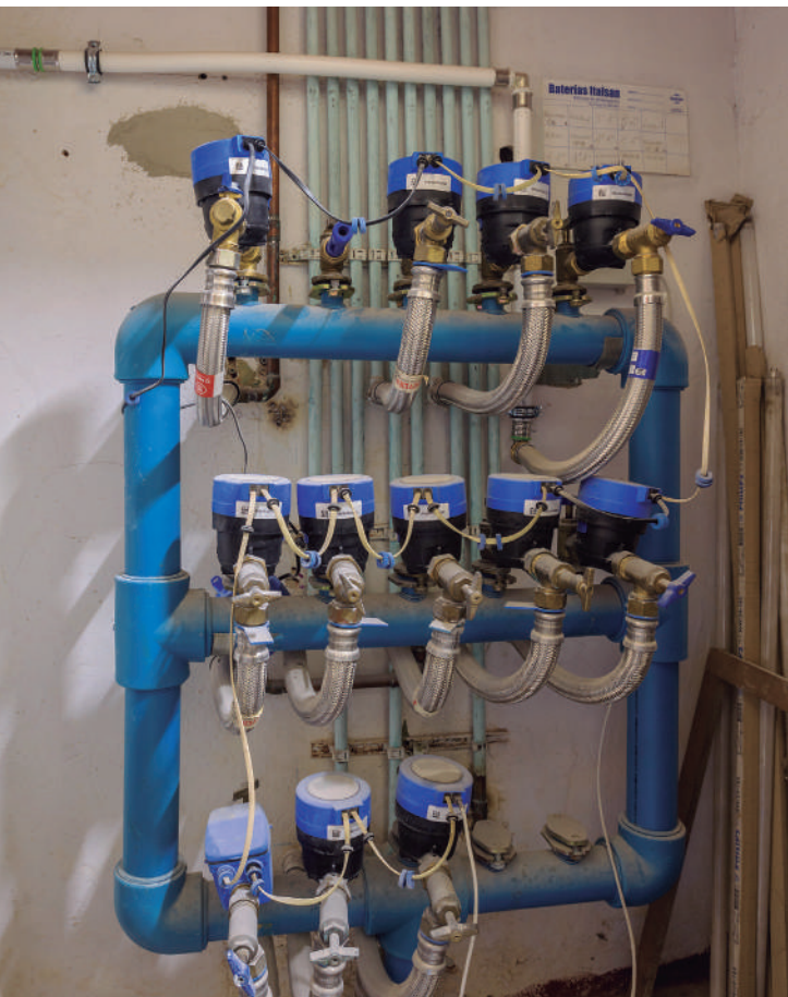
Bateria col·lectiva de comptadors d'aigua
