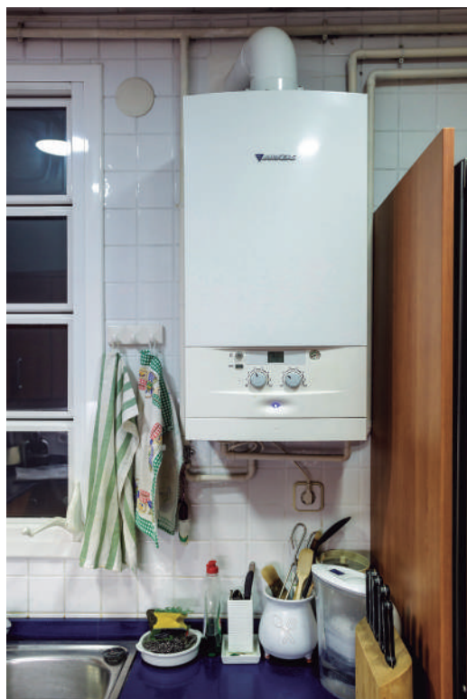
Caldera de gas domèstica
