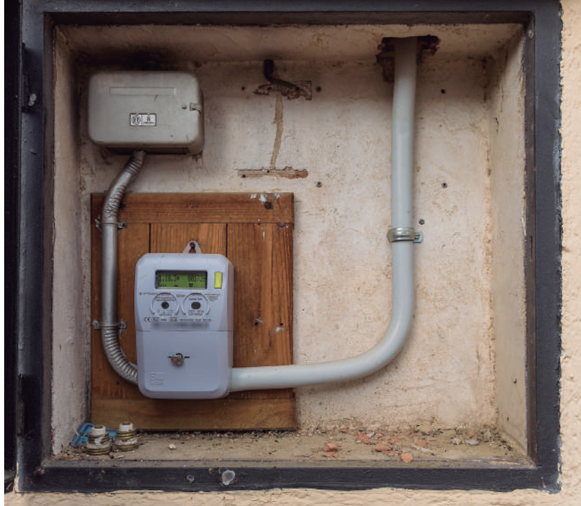
Comptador elèctric ubicat en un armari de registre d'una casa antiga
