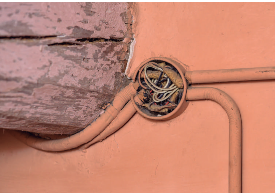
Punt de registre d'una instal·lació elèctrica amb certa antiguitat
