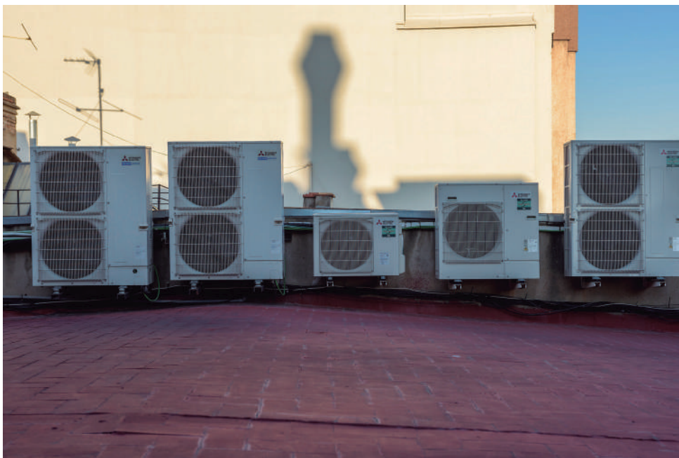
Aparells d'aire condicionat al terrat d'un edifici residencial plurifamiliar
