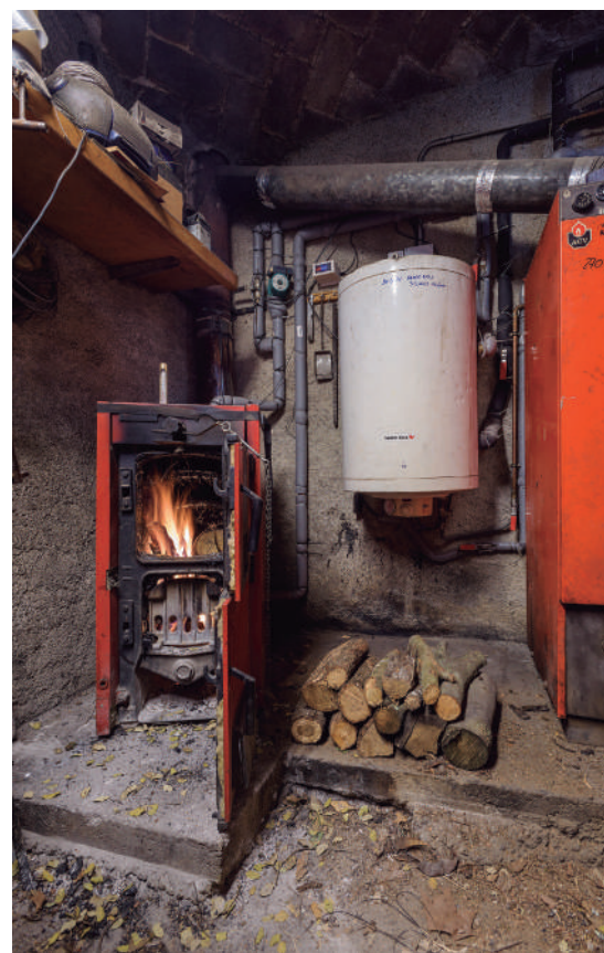
Racó d'instal·lacions amb la caldera de l'aigua calenta
