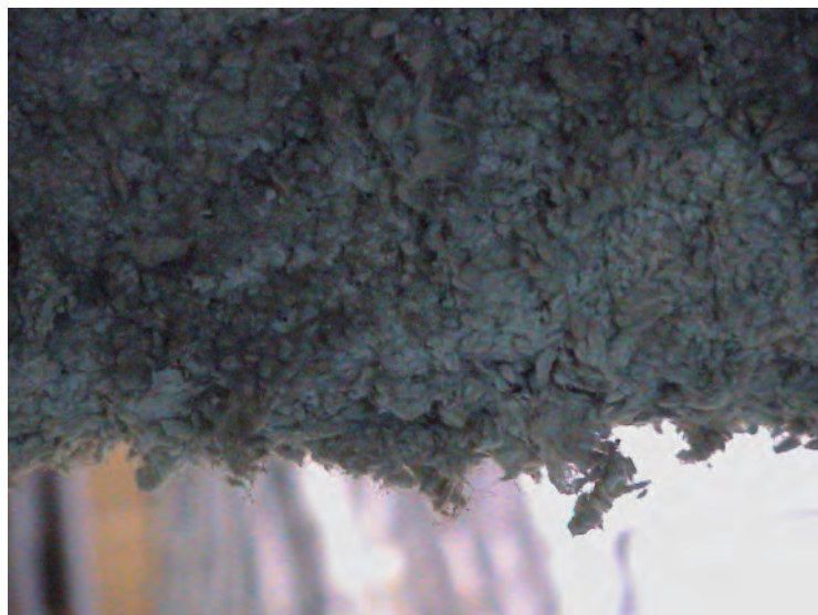
Aïllament d'amiant molt friable i d'alt risc (Imatge cedida per Joan de Monserrat)
