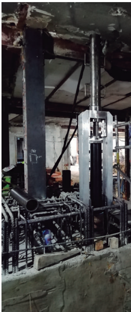
Utilitatge de clavament, bastidor metàl·lic i gat hidràulic (Fig. 1)
