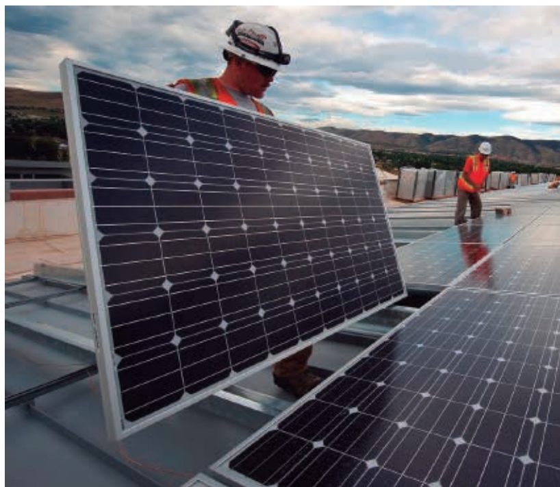
Panells de captació d'energia fotovoltaica
