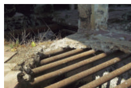
Patologia de forjats i fàbriques Data: 02/07/2020
