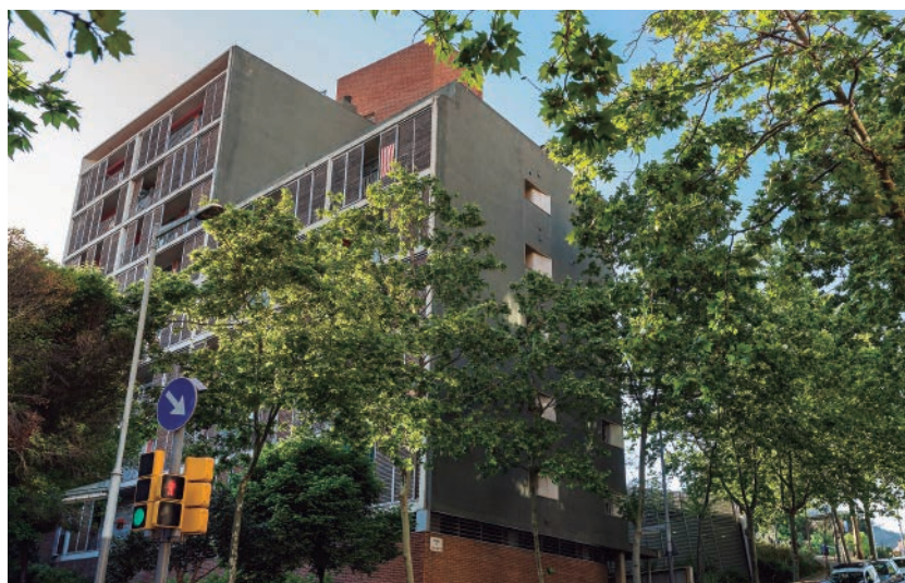
Degradació de les mampares mòbils de lames de fusta de la façana sud
