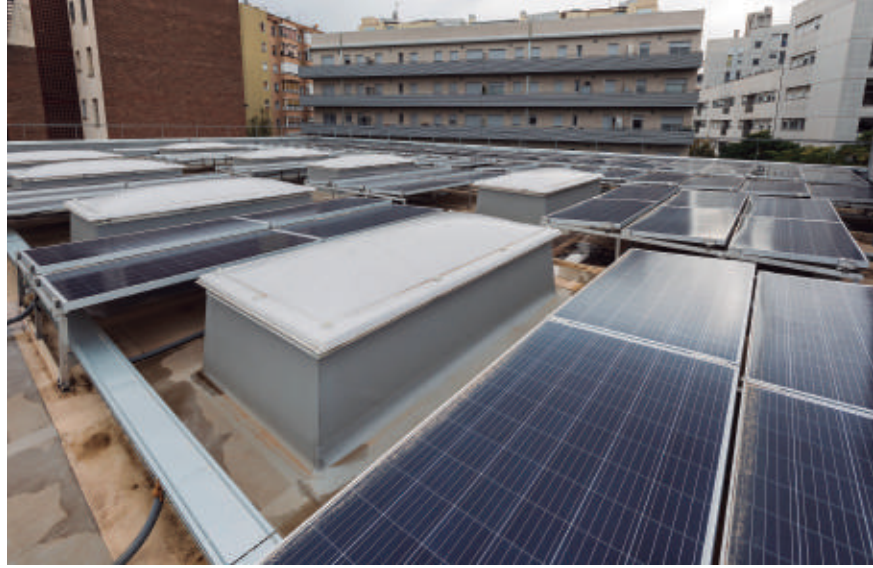
Zona d'instal·lacions i captació solar al terrat
