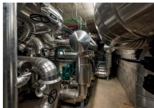
Detall de les instal·lacions
