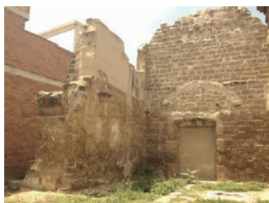
Imatges de l'estat de les ruïnes abans de la intervenció
