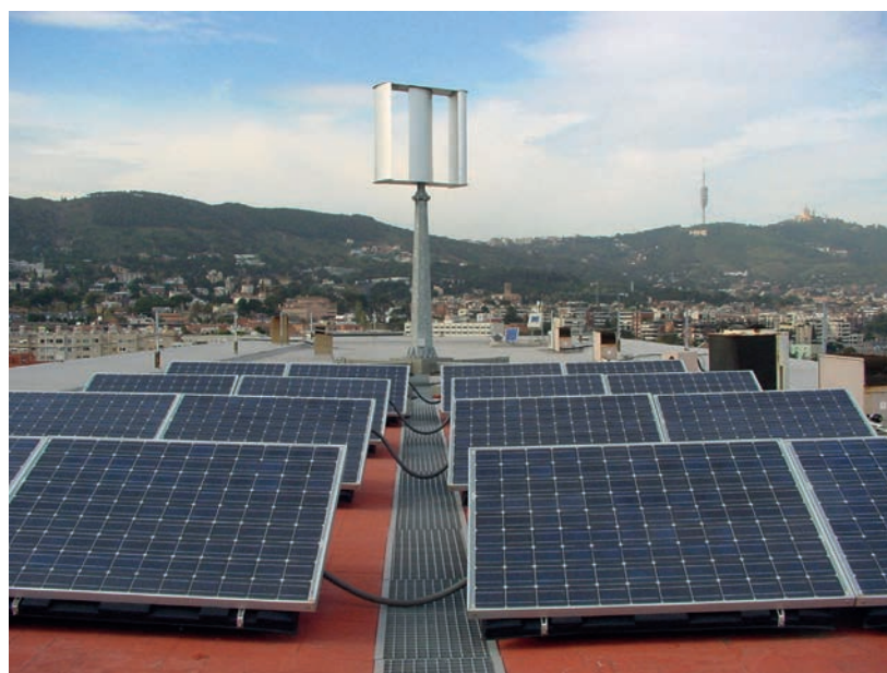
Panells d'energia fotovoltaica en el sostre d'un edifici de l'Àrea Metropolitana
