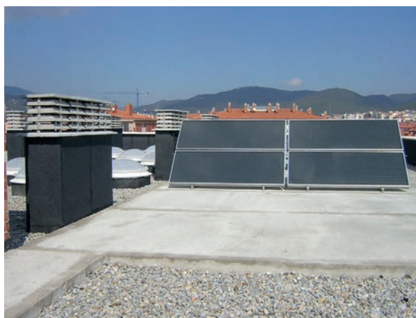
Plaques fotovoltaïques al terrat d'un edifici residencial plurifamiliar a Terrassa
