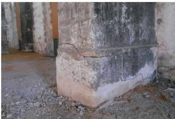
Patologia en l'interior de la bodega
