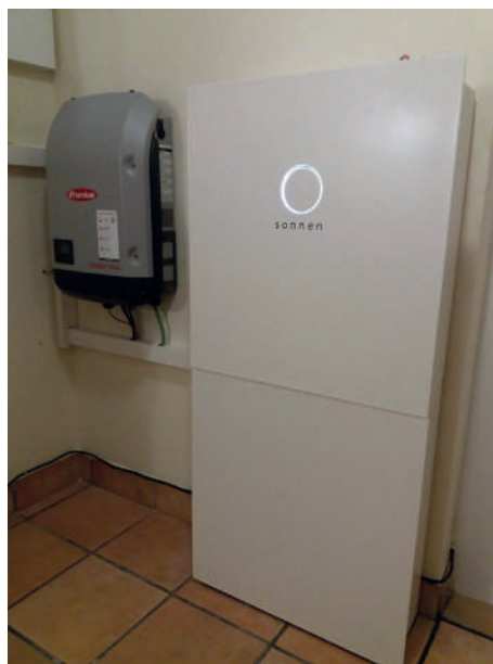
Bateria Sonnen Batterie en un habitatge
