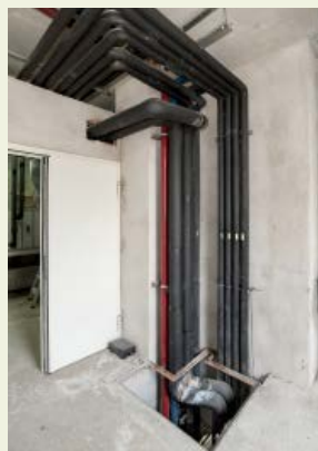
Entrada canonades a la sala de calderes i piscina
