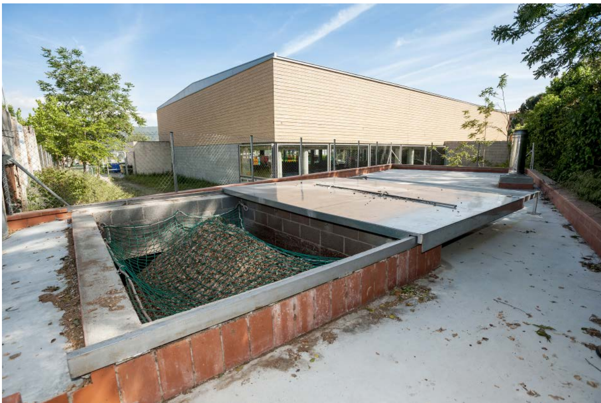
La instal·lació de producció de calor al costat de les instal·lacions esportives municipals
