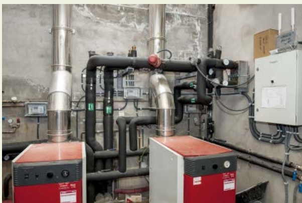
Calderes de gas de la piscina amb intercanviador
