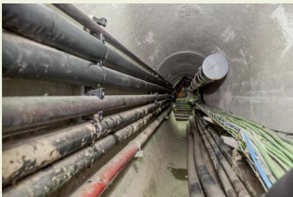
Galeria de serveis sota la grada del pavelló
