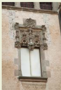
Esquerdas a la façana al carrer
