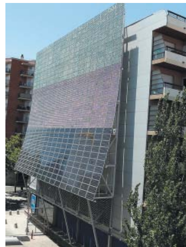
PANNELLS SOLARS QUE APROFITEN LA SUPERFÍCIE CEGA DE LA MITGERA D'UN EDIFICI D'HABITATGES
