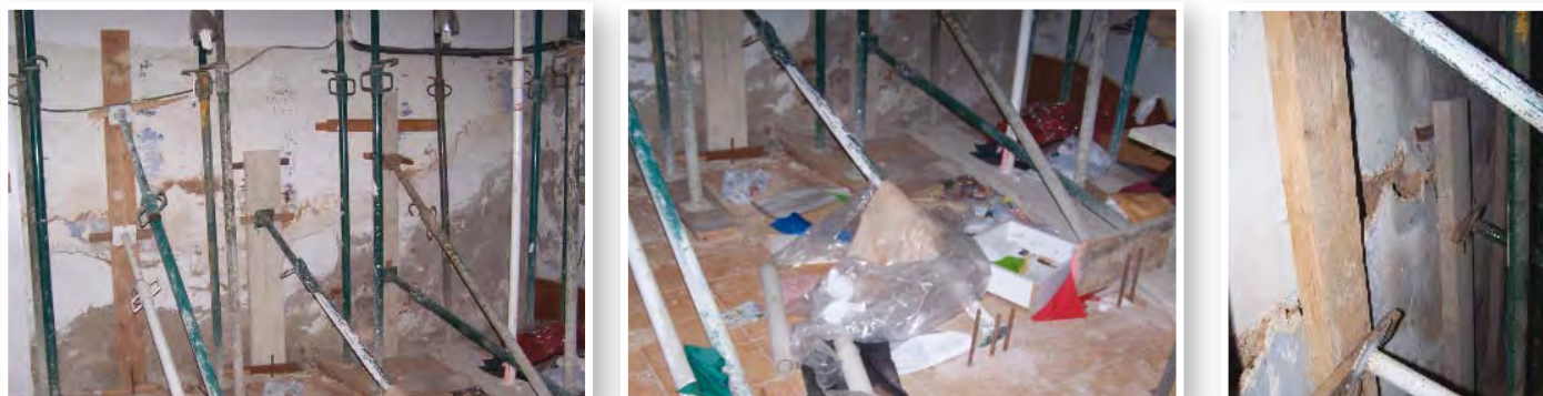
FIGURA 8.- IMATGES DE CONFINAMENT DE MITGERA AMB LESIÓ D'AIXAFAMENT EN FASE TERMINAL
