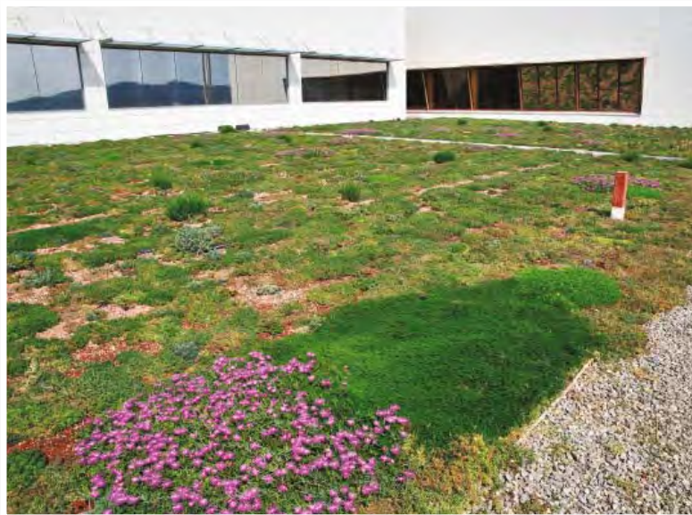
COBERTA EXTENSIVA AEROPORT EIVISSA, EMPRESES INSTAL·LADORES, PROJECTES PAISATGÍSTICS BALEARS I JARDINATURA CTMJ SL
