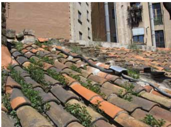
PATOLOGIES GENERADES PER MANCA DE MANTENIMENT EN DIVERSOS MONUMENTS. COBERTA MAL MANTINGUDA
