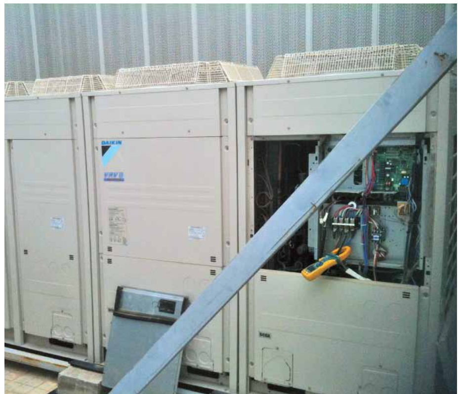
L'EXECUCIÓ D'INSTAL·LACIONS DE CLIMATIZACIÓ APOSTA CLARAMENT PER L'EFICIÈNCIA ENERGÈTICA DELS EQUIPAMENTS I LA REDUCCIÓ DE CONSUMS A TRAVÉS DE SOLUCIONS ADAPTADES A LES NECESSITATS REALS DE L'USUARI
