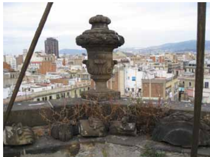
PATOLOGIES GENERADES PER MANCA DE MANTENIMENT EN DIVERSOS MONUMENTS. PÈRDUA D'ELEMENT DECORATIU PER FILTRACIÓ D'AIGUA QUE HA ARRIBAT A LA FIXACIÓ DE FERRO
