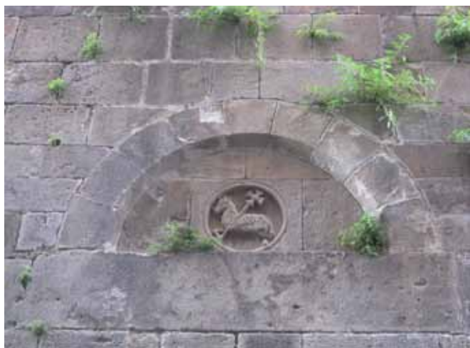
PATOLOGIES GENERADES PER MANCA DE MANTENIMENT EN DIVERSOS MONUMENTS. DETALL DE FAÇANA AMB VEGETACIÓ
