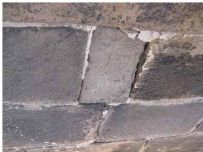
PATOLOGIES GENERADES PER MANCA DE MANTENIMENT EN DIVERSOS MONUMENTS. PÈRDUA DE MATERIAL EN JUNTES.
