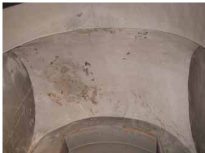
PERJUDICIS EN ELEMENTS CONSTRUCTIUS I ACABATS, PER HUMITATS CAUSADES PER MANCA DE MANTENIMENT A LA COBERTA
