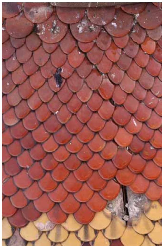
FIGURA 3. DETALL DE LA COBERTA DE LA CÚPULA ON S'APRECIA L'ESTAT DE DEGRADACIÓ DELS PERFILS METÀL·LICS MERIDIANS
