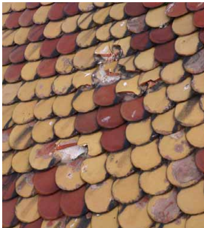
FIGURA 2. DESPERFECTES A LA COBERTA PRODUÏTS PELS IMPACTES
