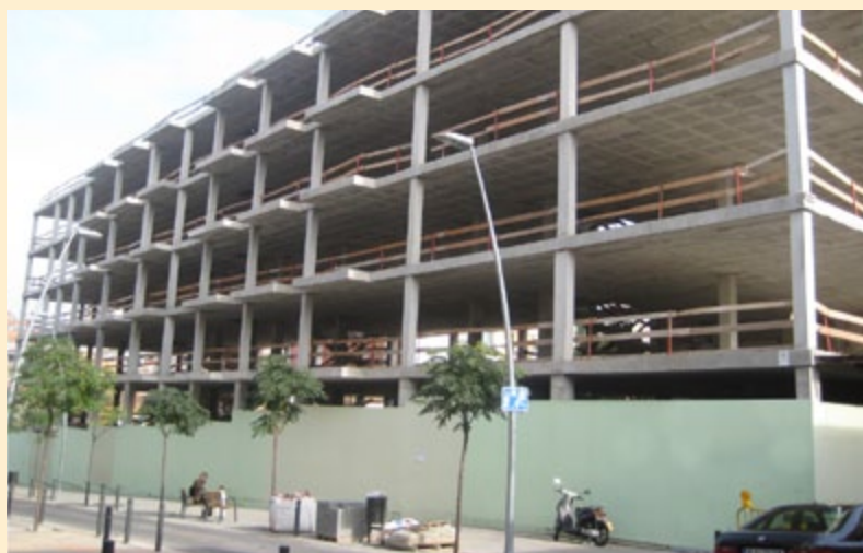
ES MANTENEN LES PROTECCIONS COL·LECTIVES
