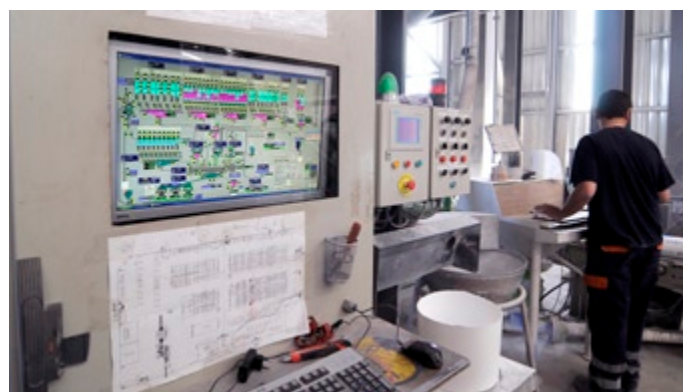
QUADRE DE COMANDAMENT DE TOT EL PROCÉS DE PRODUCCIÓ
