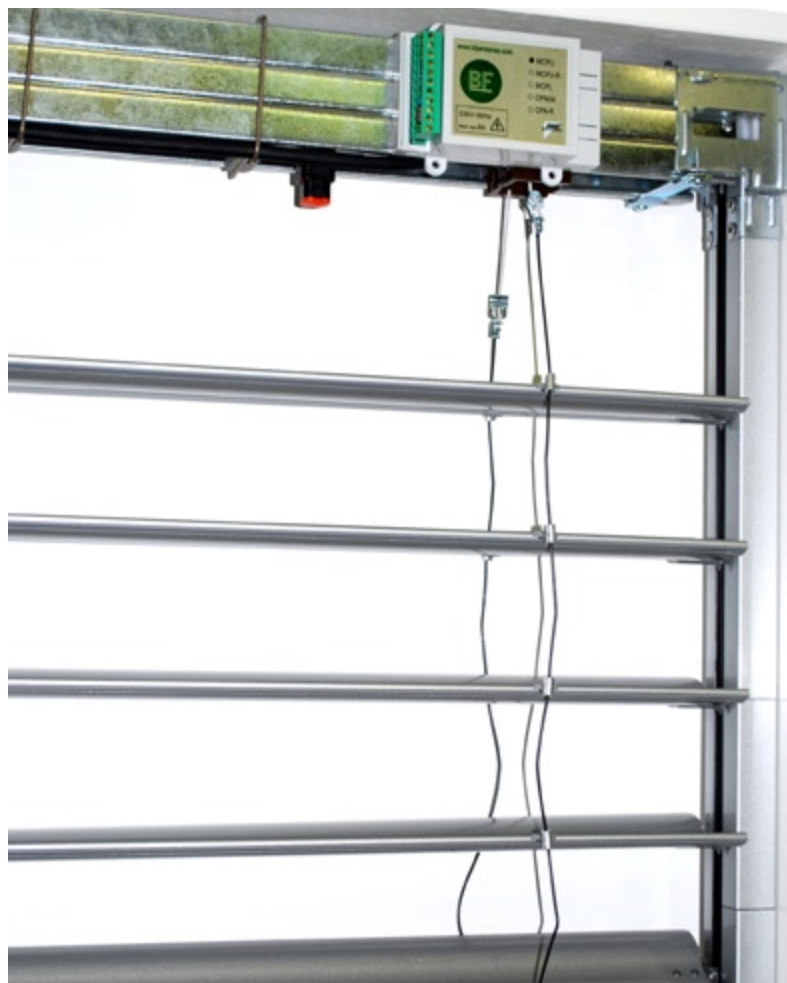
AUTOMATISME SITUAT A LA PART SUPERIOR DE LA PERSIANA (AL COSTAT DE L'EIX O DINS DEL PONT). UN COP COL·LOCADA LA TAPA DE REGISTRE NO ÉS PERCEPTIBLE VISUALMENT
