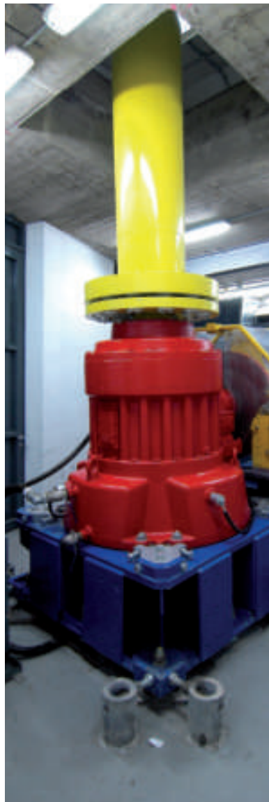
A L'ESTACIÓ INFERIOR ES TROBA EL MOTOR QUE SERVEIX A LES TRES ESTACIONS
