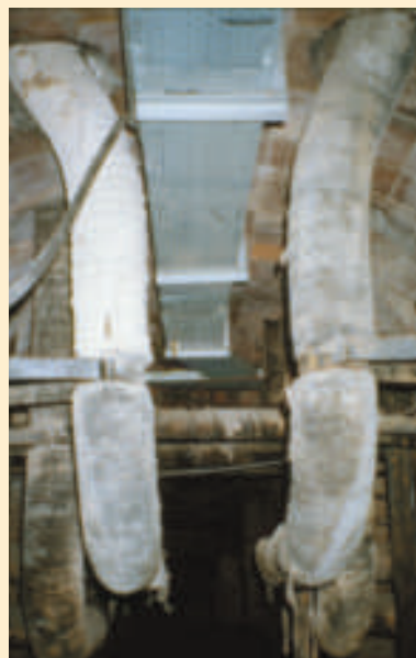
UN ALTRE EXEMPLE SÓN LES CALORIFUGACIONS DE CANONADES
