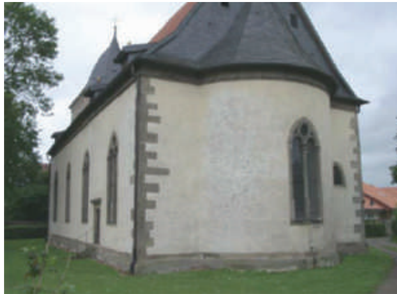
EL MESURAMENT LA HUMITAT DEL MUR ES VA REALITZAR MITJANÇANT EL SISTEMA TERMOGRAVIMÈTRIC, AMB LA FINALITAT D'OBTENIR LA MÀXIMA FIABILITAT POSSIBLE
