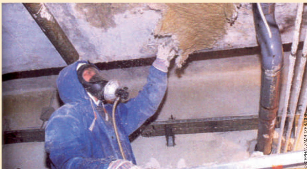
ELS TREBALLS D'INTERVENCIÓ EN EDIFICIS AMB PRESENCIA D'AMIANT HAN DE SEGUIR UNA NORMA ERICTA DE PROTECCIÓ
