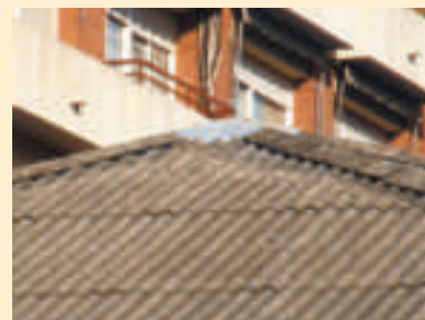
L'AMIANT ENCARA ES POT TROBAR EN LA COBERTA D'EDIFICIS
