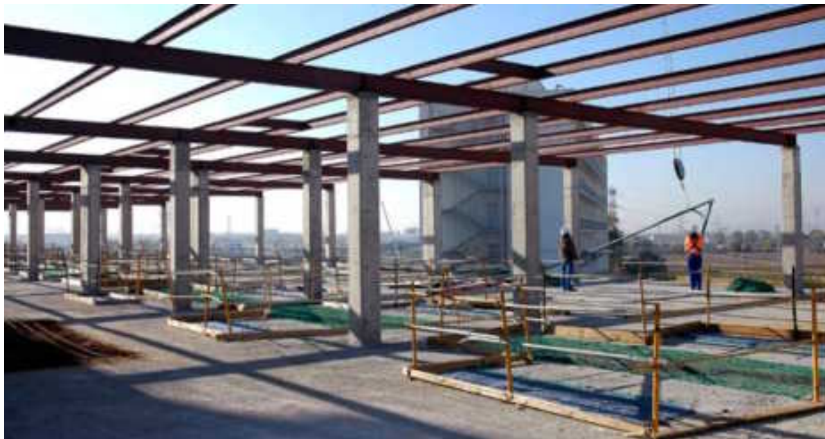
S'OBSERVA LA DOBLE PROTECCIÓ PERIMETRAL I LA XARXA HORITZONTAL IMPLANTADA EN TOTS ELS FORATS I PASSOS D'INSTAL·LACIONS DE FORJATS.
