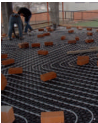
EL SISTEMA DE CALEFACCIÓ AMB CALDERA DE CONDENSACIÓ DE GAS NATURAL SUBMINISTRA AIGUA CALENTA A UNS 30° C AL TERRA RADIANT
