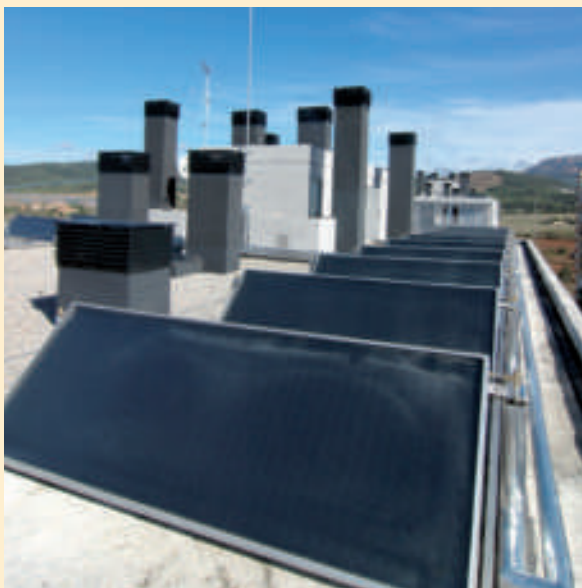
EL RITE S'APLICARÀ A LES INSTAL·LACIONS TÈRMiques EN ELS EDIFICIS DE NOVA CONSTRUCCIÓ
