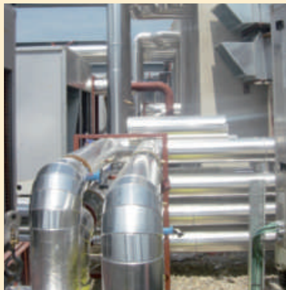
INSTAL·LACIONS A LA COBERTA DE LA TORRE DIAGONAL MAR
