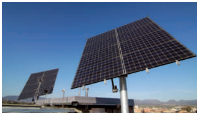
LES INSTAL·LACIONS QUE BUSQUEN L'EFICIÈNCIA ENERGÈTICA ESTAN ABANDERADES PER LES PLAQUES SOLARS DE COBERTA
