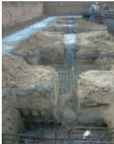
DIPÒSITS PLUVIALS SOTERRATS
