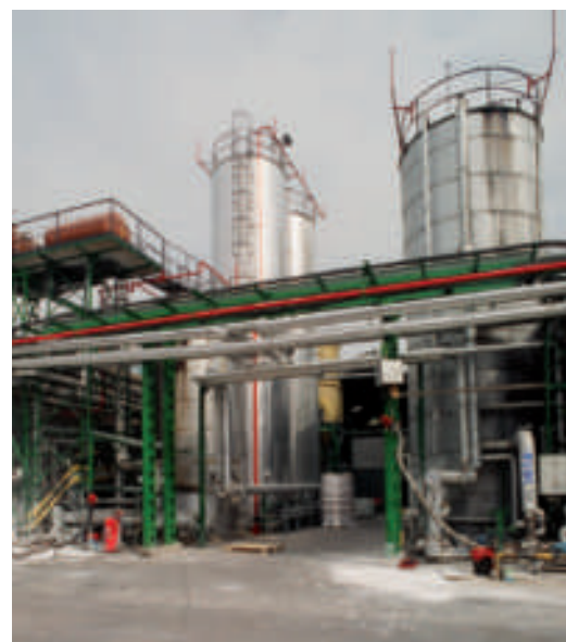
1. DIPÒSITS D'EMMAGATZEMATGE DE L'ASFALT A 200 °C
