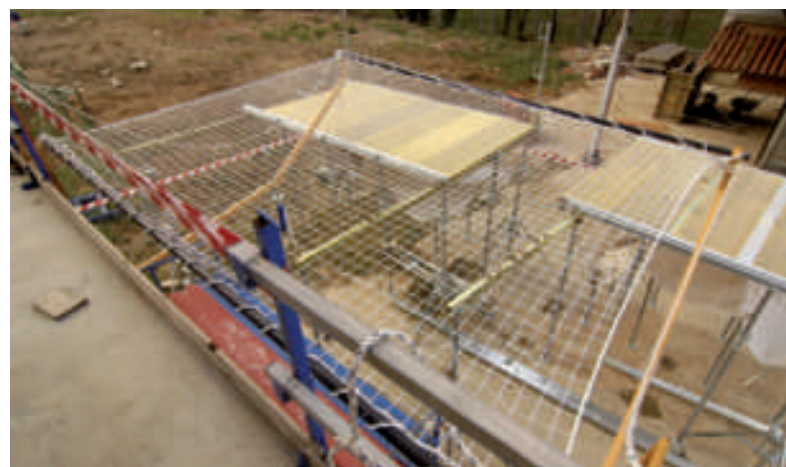
LA XARXA HORITZONTAL TÉ UN VOLADÍS DE TRES METRES I PROTEGEIX DE CAIGUDES DE FINS A SIS METRES D'ALÇADA
