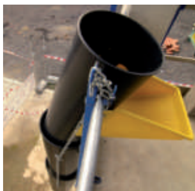
SISTEMA CORRECTE DE PROTECCIÓ DE LA CAIGUDA DE RESIDUS
