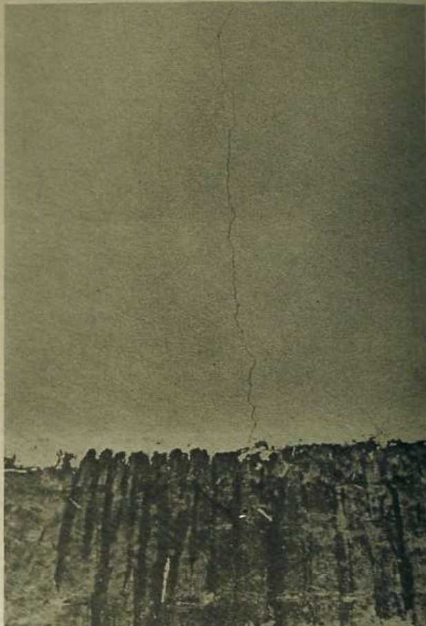
51 Es frecuente la aparición de flechas excesivas e incluso grietas debido al mal comportamiento del conjunto
