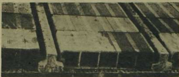
48 El acabado superficial liso no permite una buena adherencia entre el hormigón prefabricado y el vertido en obra
