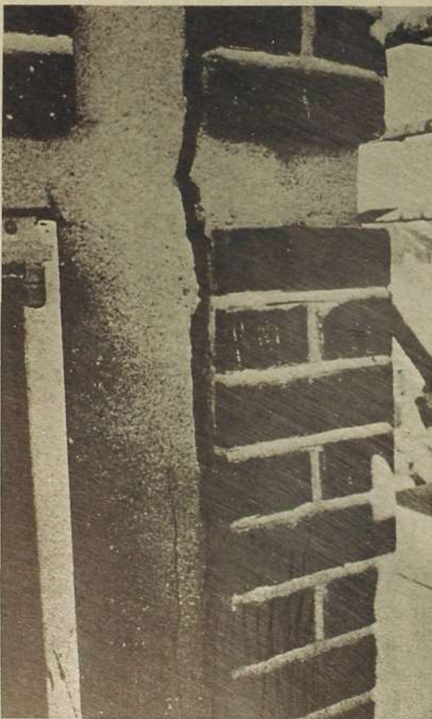
31 La falta de compatibilidad entre los elementos de un edificio, suele ser la causa de daños importantes
