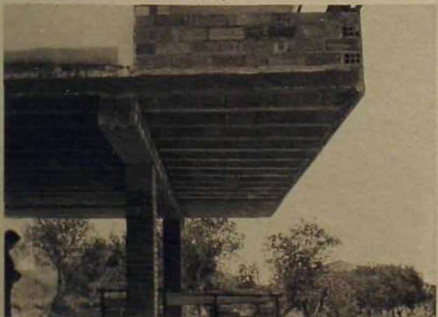
16 Los problemas de relajamiento de las viguetas pretensadas se agudizan en los voladizos por el efecto del pretensado.
