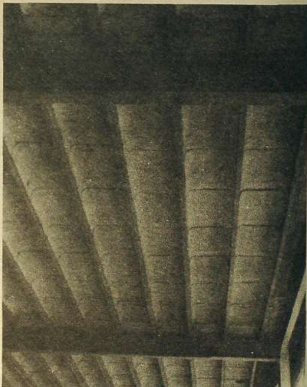
16 El progresivo aligeramiento del forjado, invalida cada vez más los datos obtenidos en laboratorio sobre una losa maciza.
