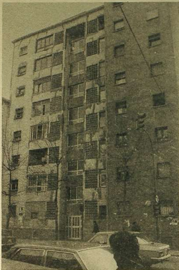
3 La mala calidad de los materiales utilizados ha sido la causa principal de los problemas que sufren las viviendas.
