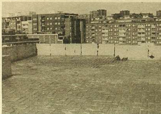
4 Cubierta de uno de los bloques. La mala construcción de este elemento ha permitido el paso de agua a los pisos inferiores.
