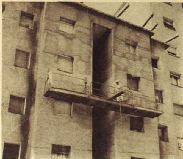
1 Espuma aislante proyectada in situ. Obsérvese el aspecto final de las aristas debido a la poca uniformidad de la capa aislante.
