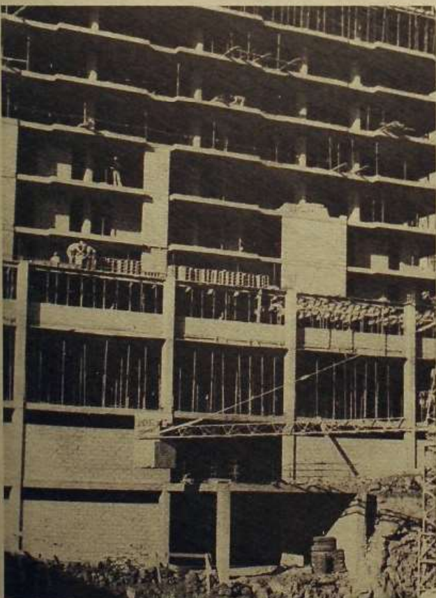
3 Las nuevas tecnologías del hormigón armado permiten grandes luces que acarreen deformaciones capaces de lesionar a la tabiquería.
