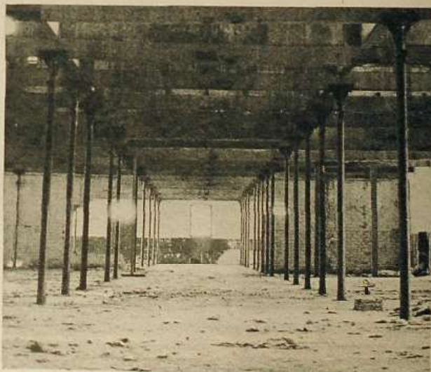
El desguace de chatarra ha acelerado la ruina en muchos casos. Incluso han sido sustraídos pilares de hierro fundido de las naves tanteando el equilibrio de la cubierta.
