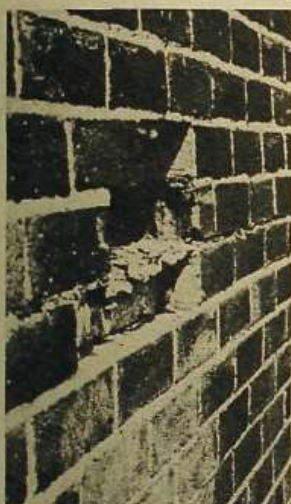
1 Ejemplo típico de rotura y despegue de las plaquetas de ladrillo en la losa de hormigón.
