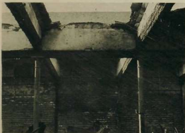
Aspectos del estado en que quedó una fábrica de la calle La Llacuna, en el barrio del Poble Nou de Barcelona, después del incendio sufrido recientemente. Este edificio industrial, de mediados del siglo pasado, era un característico ejemplo de los inicios de la arquitectura del hierro en Catalunya, de los que ya quedan pocos. Las bóvedas que aparecen en las fotografías son una muestra inestimable de las soluciones «a la catalana», hoy, desgraciadamente en desuso.
