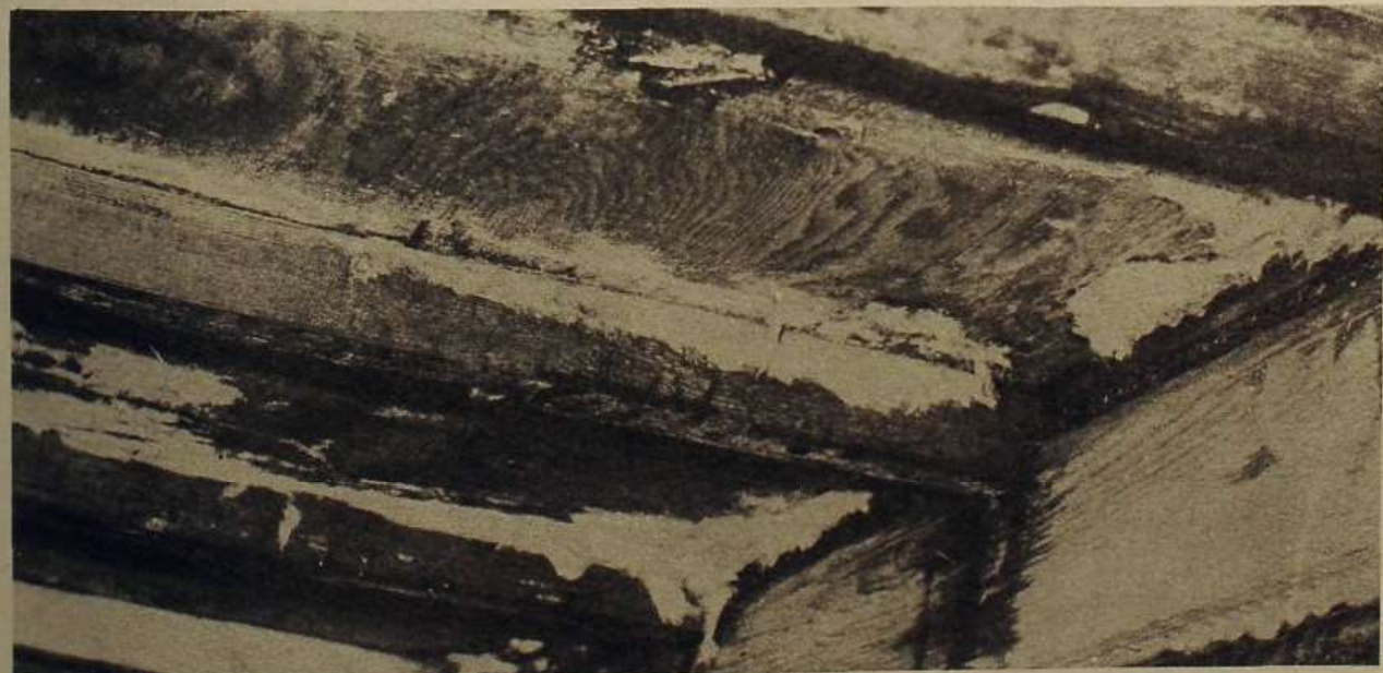
3 Aparición de moho en la madera de la cubierta; probablemente por problemas de condensaciones. Ver figura 1.
