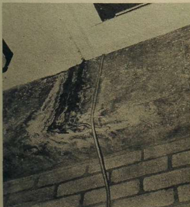
2 Filtraciones por humedad intersticial de los materiales.
