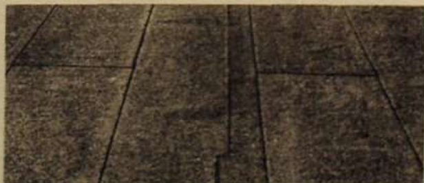
9 Arrugas en el fieltro, entre las separaciones de los tableros aislantes sobre los que se coloca. Se distingue de los dos casos siguientes por el hecho de que las arrugas son rígidas si se las aprieta. La forma de las arrugas es un reflejo de la falta de regularidad de la base.
