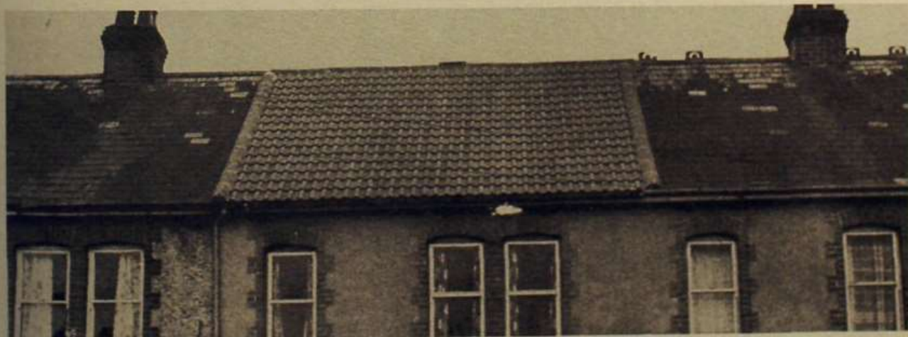
1 Las obras de reparación pueden producir unos cambios inadmisibles en el aspecto del edificio.
