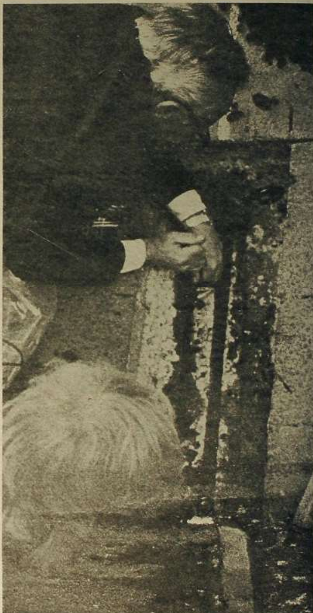
5 Tratando de extraer una masilla muy húmeda de la junta de dilatación.
