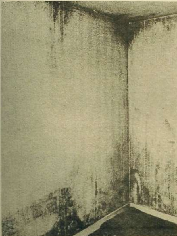
3 Tercera forma de manifestarse la humedad (ver 1, 2). En este caso lo difuso de la humedad (al contrario de las manchas o bandas bien definidas), y la presencia de moho (el cual requiere que la humedad relativa del aire sea superior al 70 %, para que pueda crecer) nos sugiere que la causa principal es la condensación. En la investigación se debe comprobar esta deducción de partida.
