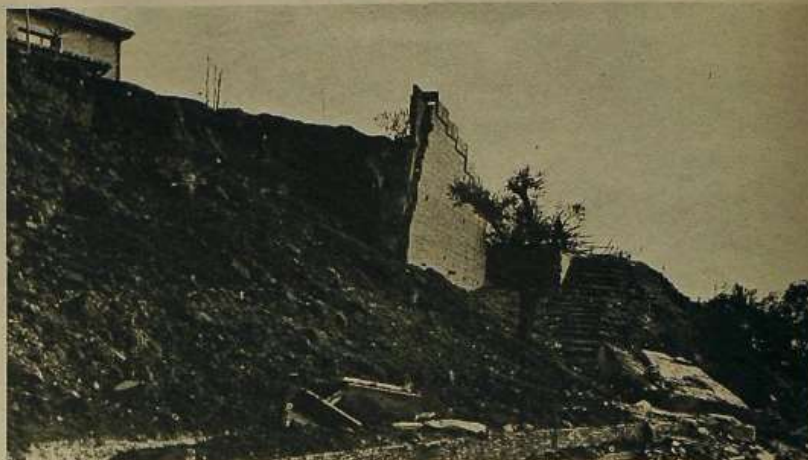
El olivo situado en la parte superior, se deslizó junto con el suelo hasta la posición que ocupa en la fotografía.
