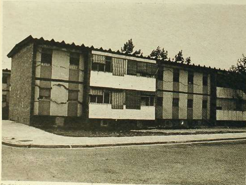
Se dice que los vecinos se saludaban pasando la mano a través de la grieta.
