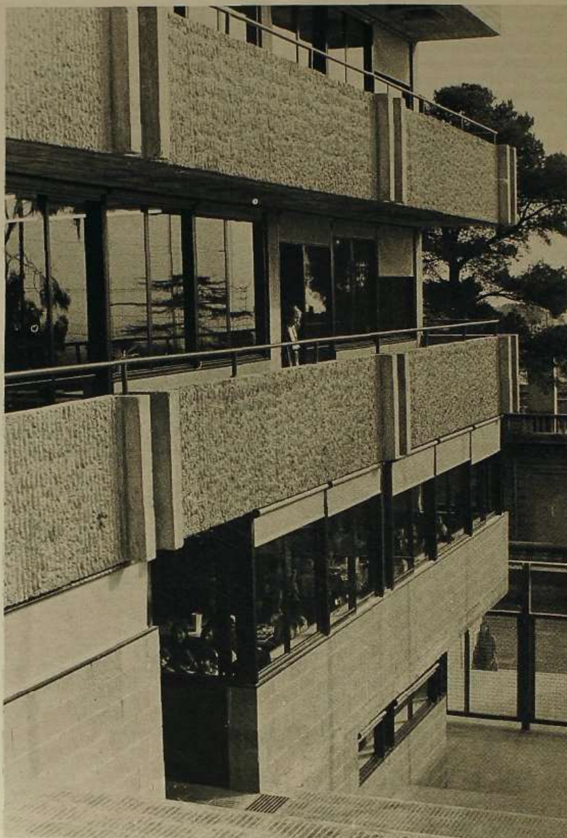
Las barandillas realizadas con hormigón vertido en obra con un grecado roto, han constituido una partida de coste imprevisto muy elevada.
