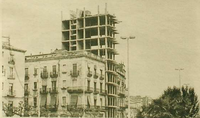
4. Pendiente de resolución judicial esta estructura no deja dudas sobre las características del Ayuntamiento que la permitió.
