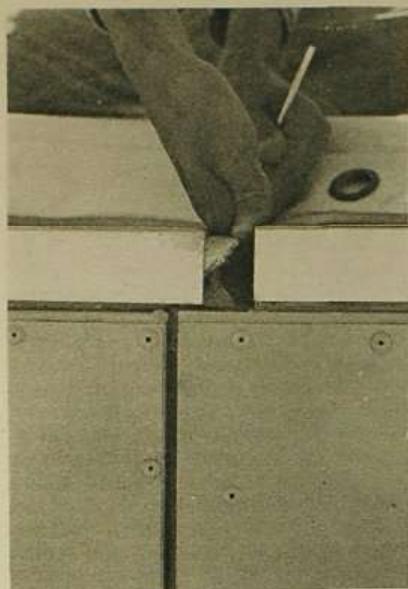
Los defectos, una vez montado.
